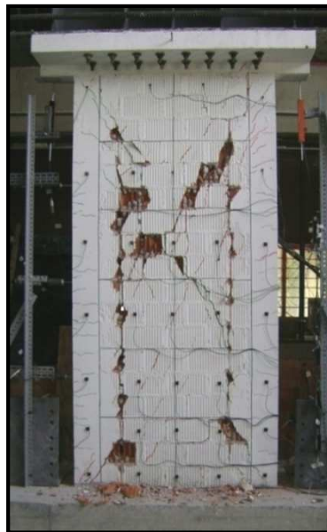
Figura 3.2. Estado final de falla del muro ME1
