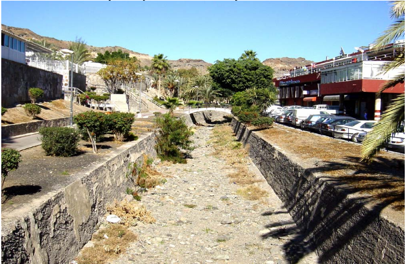
Foto No.13.1.-Colector pluvial y de Tormentas. Playa del Cura. Gran Canaria. 2005.
