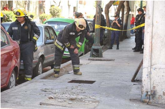
Imagen 8.- Corto circuito registrado en instalaciones subterráneas de cableado eléctrico (mufa), en la Colonia Guerrero, Delegación Cuauhtémoc, muy cerca de la Alameda Central. 10
