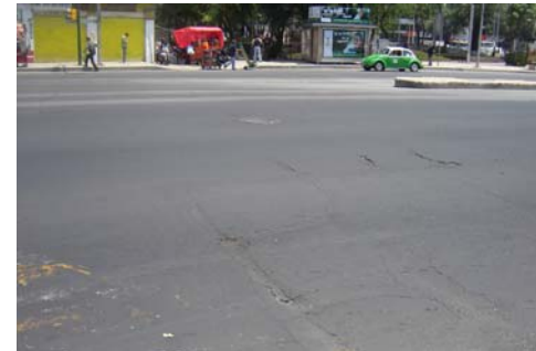
Imagen 68.- Estado del pavimento en algunas zonas de la Avenida de los Insurgentes 43 .
