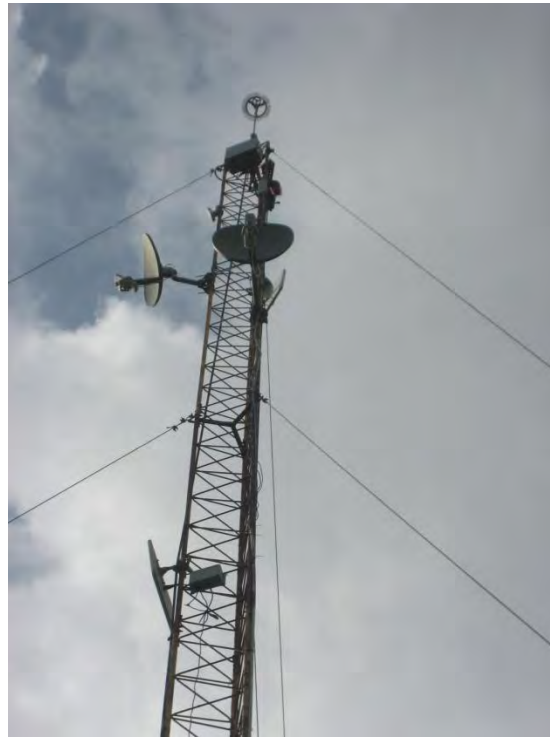
Figura 28 - Antena BH (Colonia 20 de Noviembre).
