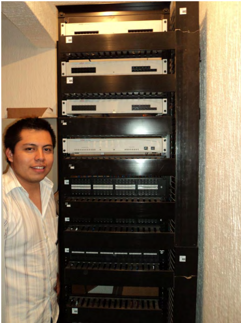
Figura 33- Rack en CAPAMA.
