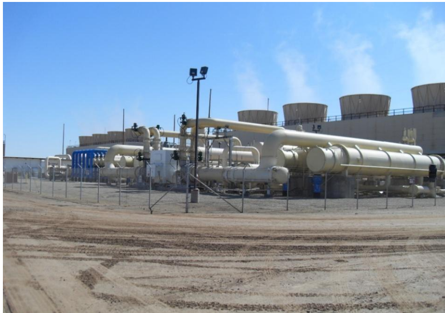
Figura 1.25.- Central de ciclo binario, East Mesa, California 2009.
