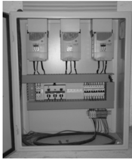
(b) Caja de control
