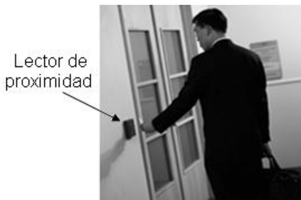
Figura 4.22b.- Control de acceso por lector de proximidad.
