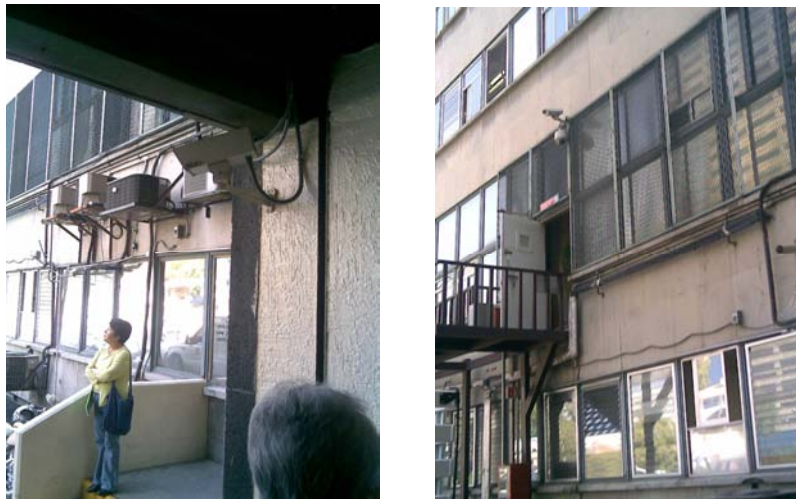
Fig. 34 cámara fija en el área de carga y descarga y cámara y domo de acceso trasero
