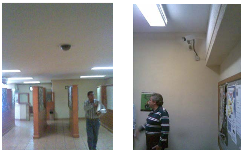
Fig. 33 Cámaras para vigilar acceso de personal y entrepiso de escalera
