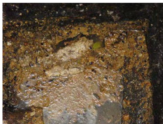
Figura 3.13 Grasas y aceites en el registro de la línea de drenaje de cocina.
