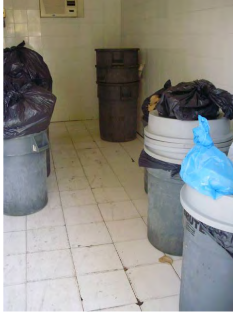
Figura 3.18 Cámara de residuos húmedos con aire acondicionado.
