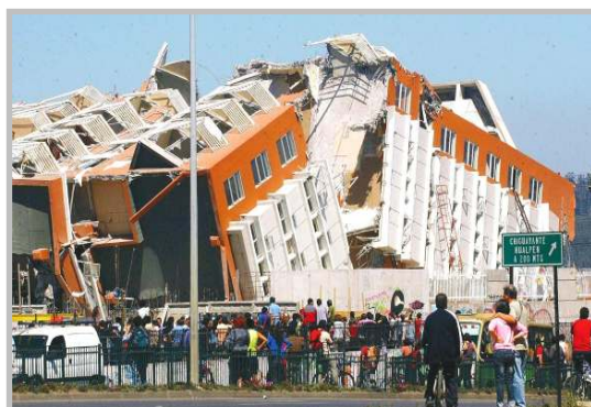
Fig. n° 18. Edificio de departamentos Borde Río destruido luego del terremoto del 27 de Febrero de 2010, Concepción, Chile.
