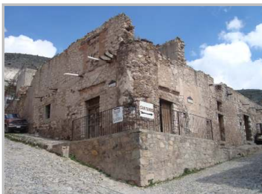
Fig. n° 9. Edificación abandonada y deteriorada en Real de Catorce, edo. de San Luís Potosí, México.
