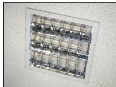
Balastro colocado a cielo raso de 3 lamparas con marco de chapa blanca desmontable y difusores reflejantes de aluminio
