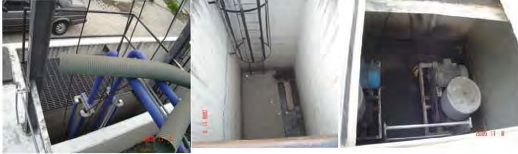
Bomba de succión de agua.
