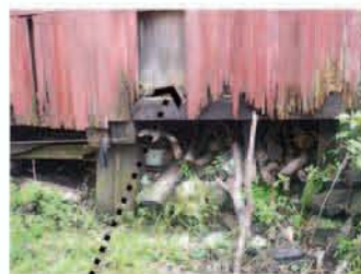
Deterioros en Fachada
