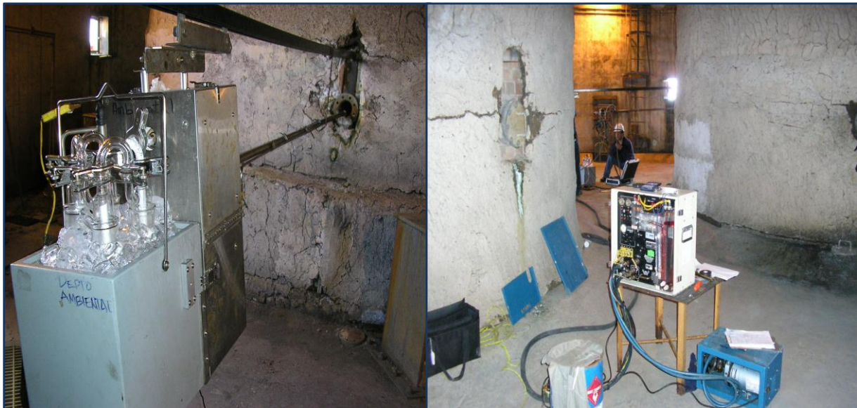
Figura 3.2. Muestreo de partículas en la Central Termoelectrica
