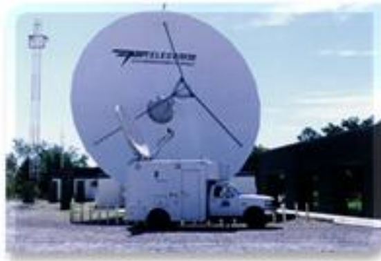
Fig. II.6. Estación terrena transportable de Telecomm.
