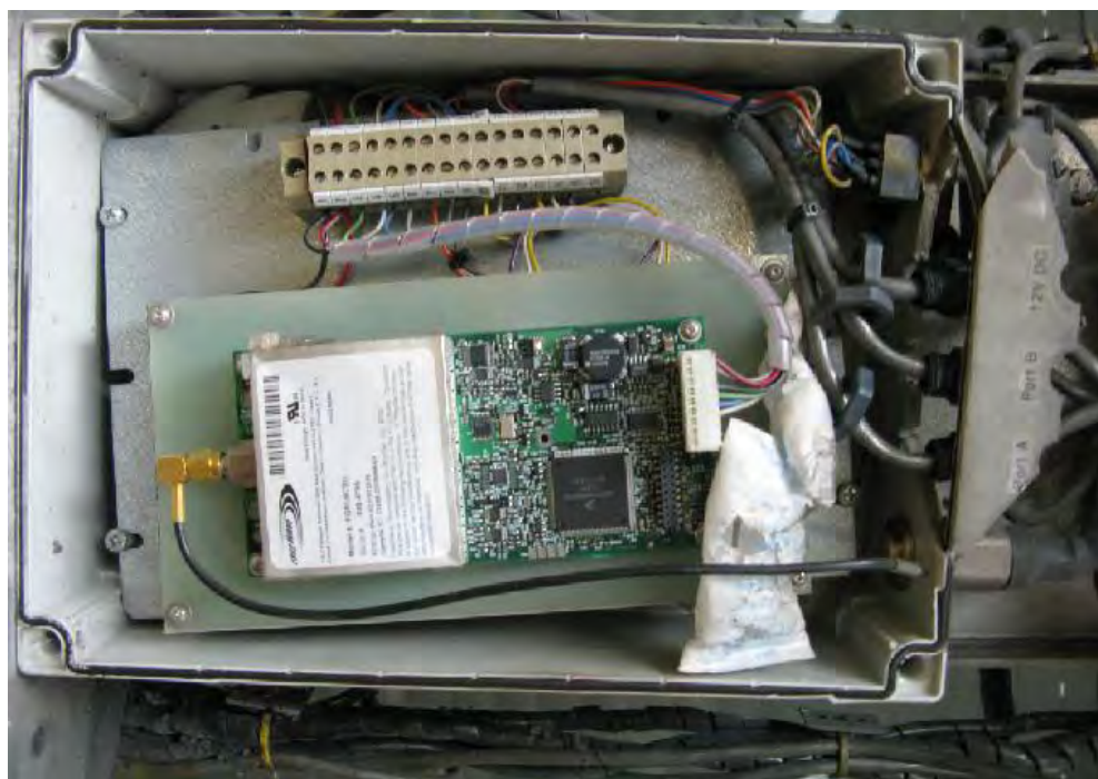
Figura 4.1 Radio módem destruido
