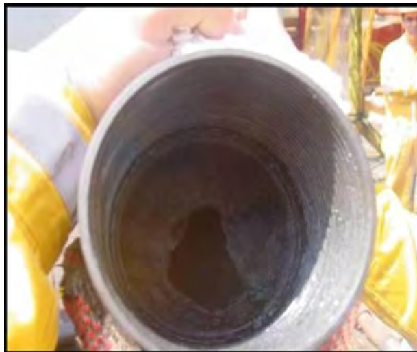
Fig.-1 Parafina obstruyendo una tubería de producción
