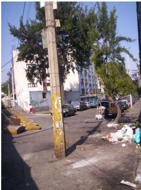
Postes de luz en total deterioro
