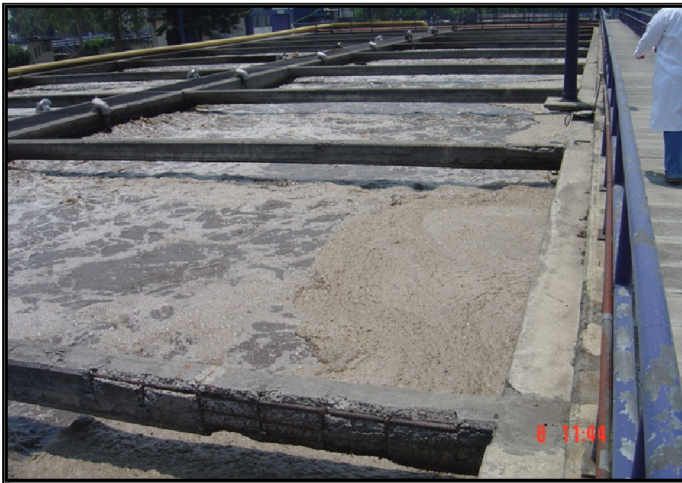
Fig. 3. Estación 2.-Tanque de Lodos Activados de la Planta de Tratamiento Cerro de la Estrella, Iztapalapa.
