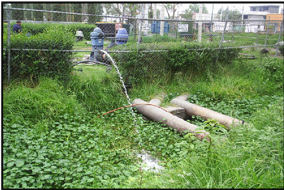
Fig. 5. Estación 4.- Punto de Rebombeo de la Planta de Tratamiento hacia los Canales de Xochimilco.
