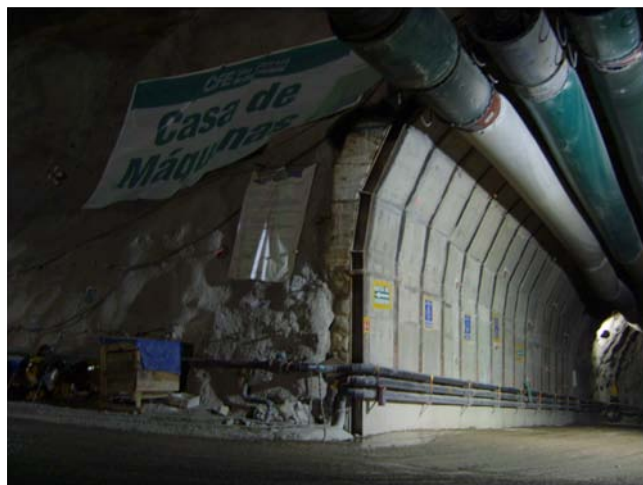
Casa de máquinas del P.H. La Yesca
