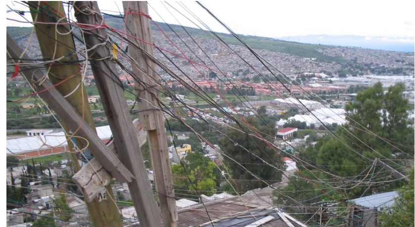
INSTALACIÓN ELÉCTRICA EN LA ZONA
