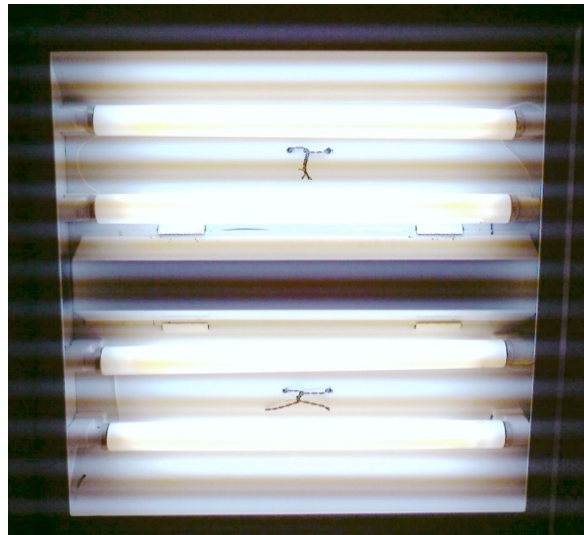
Figura 48. Lámpara fluorescente substituida de cuatro tubos fluorescentes de 21[W] cada uno.
