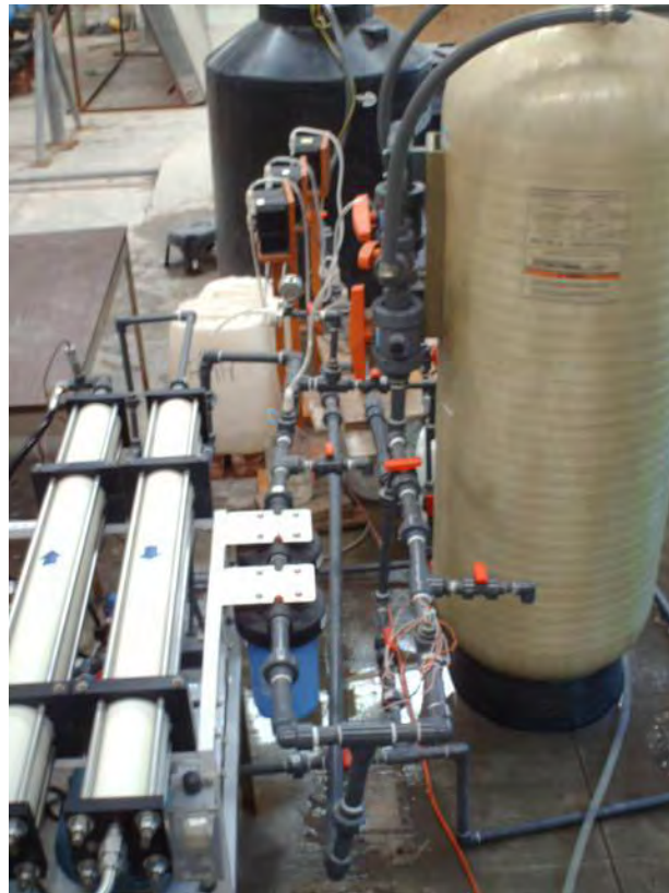
Fotografía 3.6 Instalación completa de ósmosis inversa
