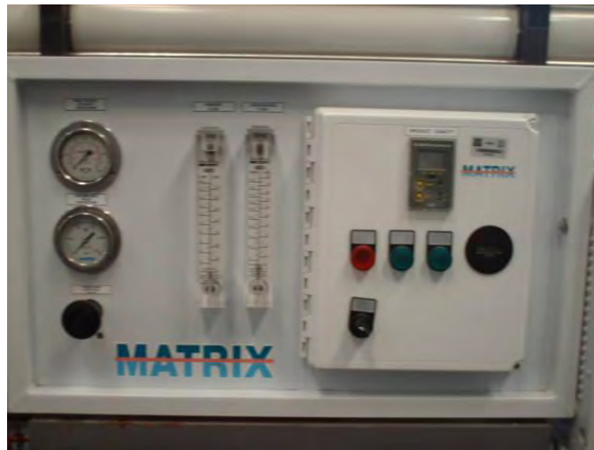
Fotografía 2.2 Tablero de sistema de ósmosis inversa
