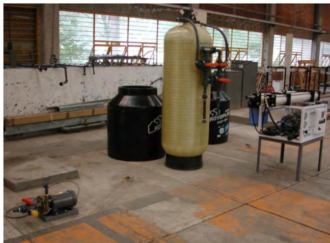
Fotografía 2.1 Equipo de ósmosis inversa
