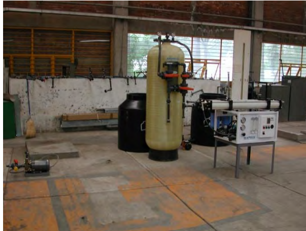
Fotografía 3.1 Equipos que componen la planta piloto de ósmosis inversa
