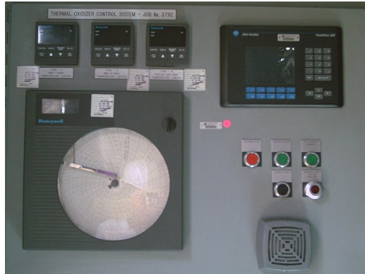
Figura 3.3 Sistema de control del Oxidador
