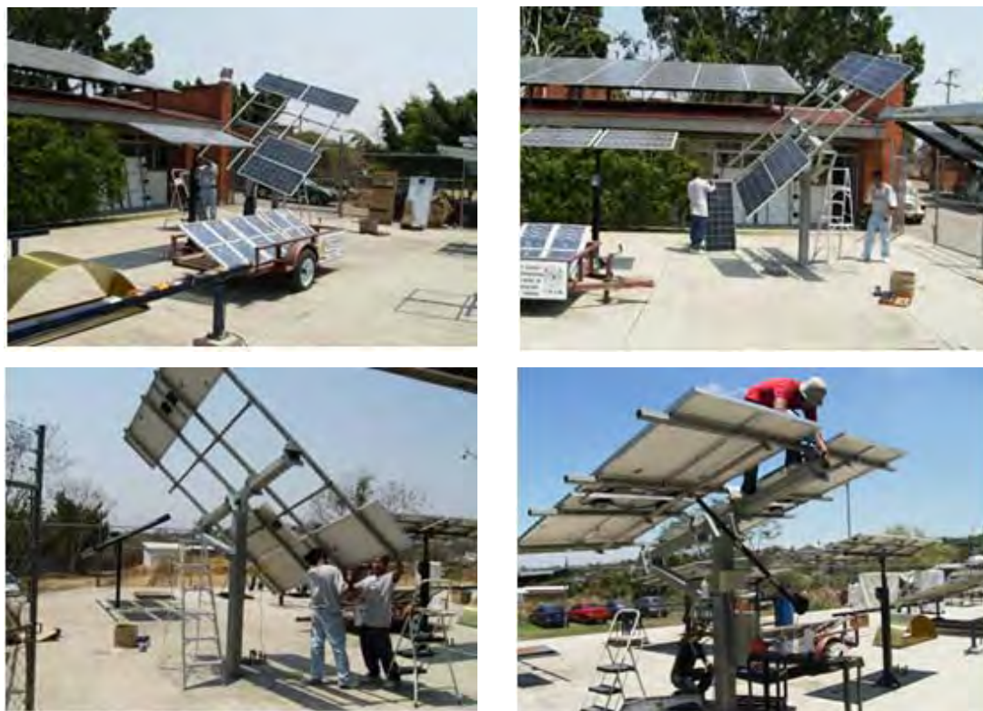
Figura 4.5 Integración del seguidor solar y sistema fotovoltaico de 1kW p .
