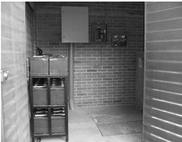
Figura A5.8 Vista del interior de la caseta de c.d., controladores de carga, bus de c.d. y banco de baterías.
