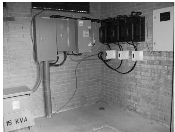
Figura A5.9 Vista interior de a caseta de c.a., red eléctrica, centro de carga del edificio "E", sistema de inversores e interruptor de transferencia.
