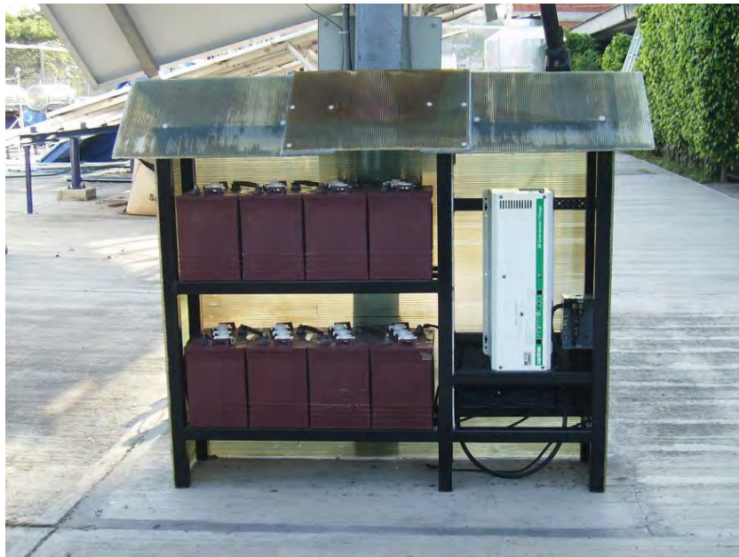
Figura 4.37 Integración de banco de baterías e inversor.
