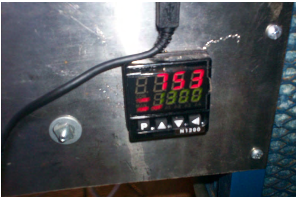
Figura 5.6: Medición de la temperatura por el controlador.
