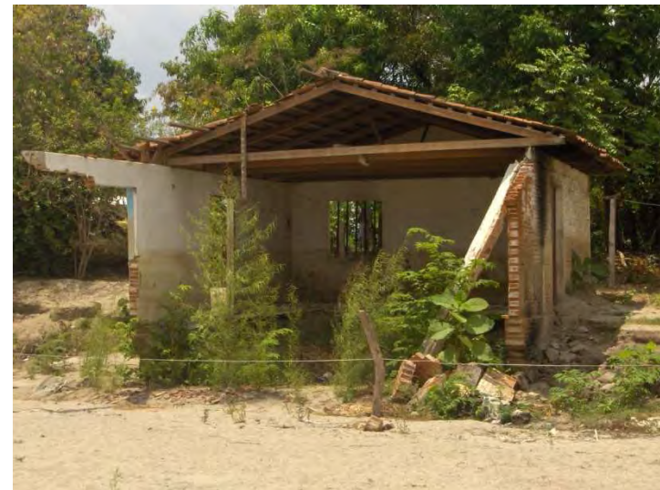
Fotografía: Casa en Huixtla después del paso del huracán Stan, 2006
