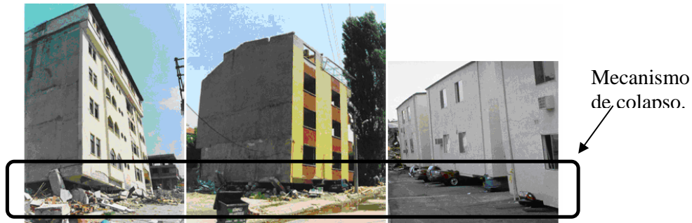
Figura 1.10 Falla por piso suave
