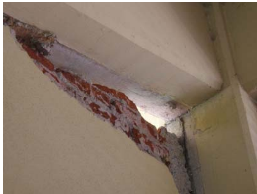
Figura 1.3 Daño en muro divisorio
