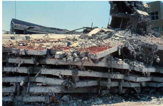
Figura 1.1 Falla por columnas débiles
