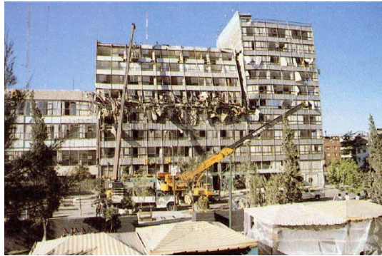
Figura 1.7 Daño ocasionado por choque entre estructuras
