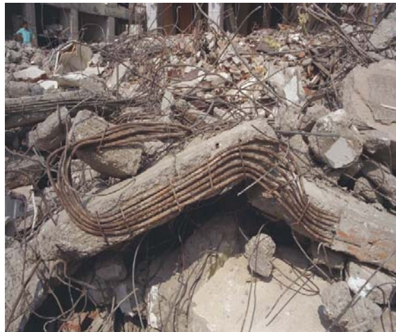
Figura 1.6 Falla debida a la alta concentración de acero de refuerzo longitudinal
