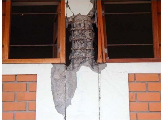
Figura 1.5 Daño producido por la colaboración inadecuada de muros
