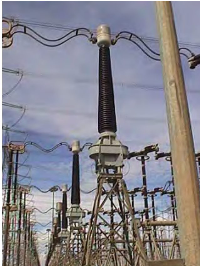
TRANSFORMADOR DE CORRIENTE
