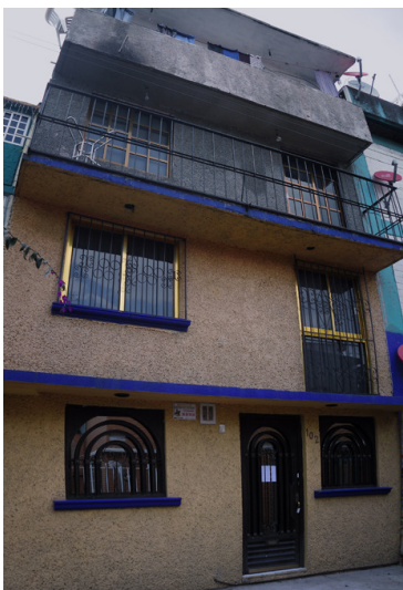
Foto 46. Vista parcial de la fachada principal con ampliaciones. Foto: Alberto Tello. Fecha: 17/12/09
