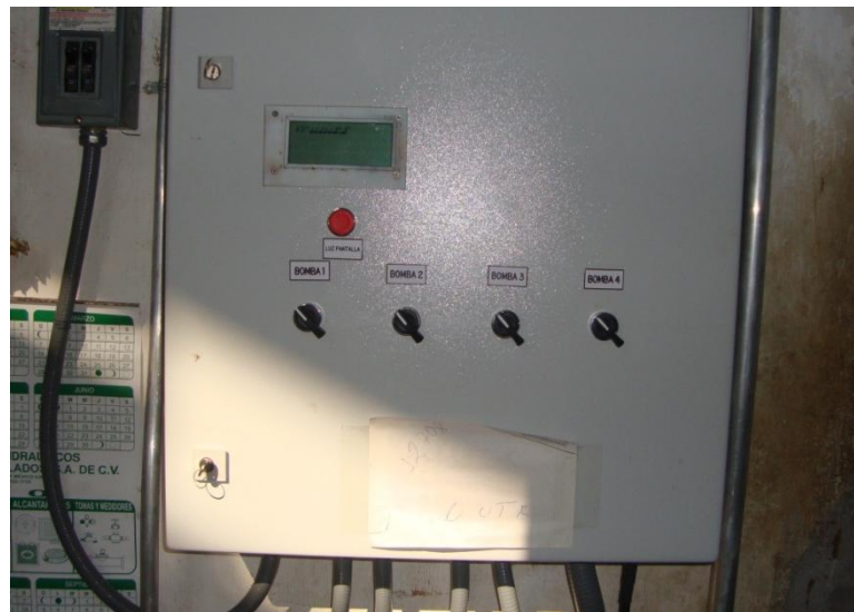
Fig. 7 Foto de los botones de cambio en una estación de bombeo.
