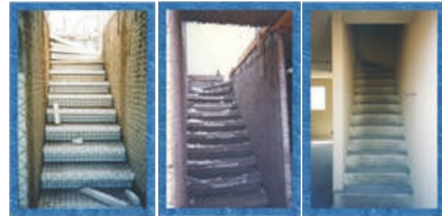
IMAGEN 29. Escalera con panel
