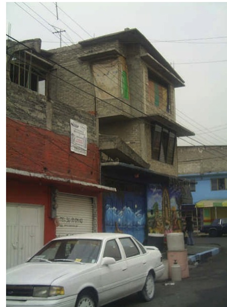
IMAGEN10. Falta de acabados
