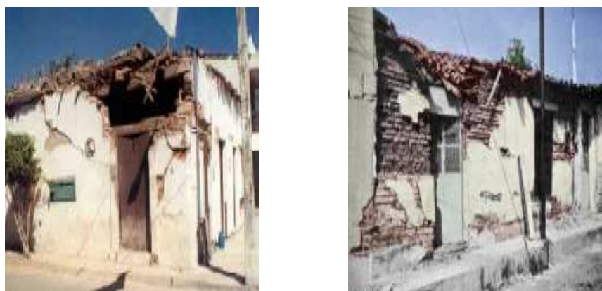
Figura 2.3 Daño en aberturas por falta de confinamiento (López y Teshigawara, 1997)
