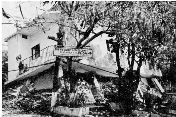
Figura 2.5.- Colapso debido a la escasez de muros en planta baja (López y Teshigawara, 1997)
