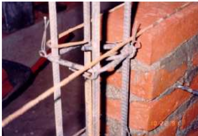
Figura 2.17.- Anclaje de un alambre corrugado de 5/32" en el acero longitudinal de un castillo (Sánchez y otros, 1992)
