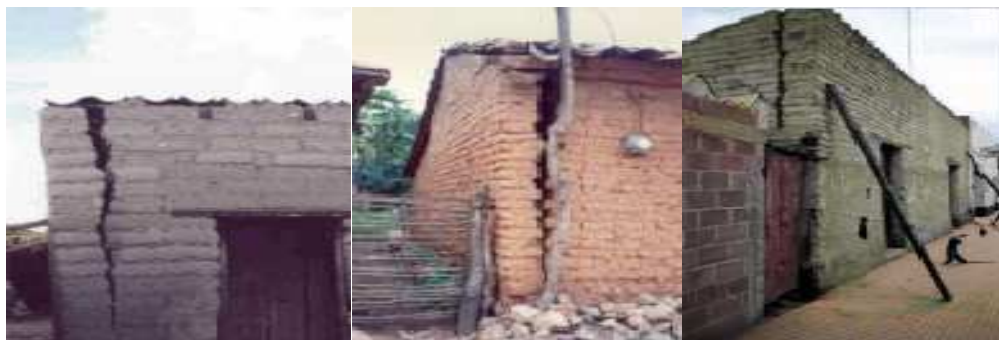
Figura 2.2.- Agrietamiento vertical en esquinas (Juárez y otros, 2000)
