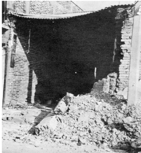
Figura 2.4.- Inadecuada conexión de muros de mampostería con elementos Confinantes (López y Teshigawara, 1997)
