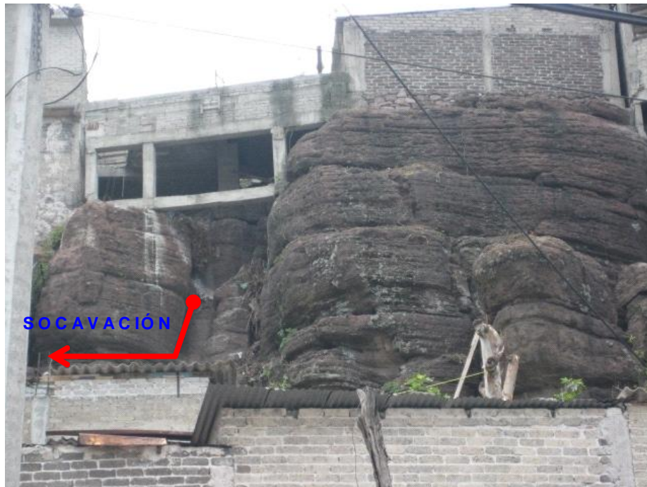
Figura 38. Manzana 16 – Lote 8. Estructura construida sobre dos cuerpos de roca. Pese a sus discontinuidades y pequeños huecos observados, la roca es estable y con alta resistencia mecánica.
