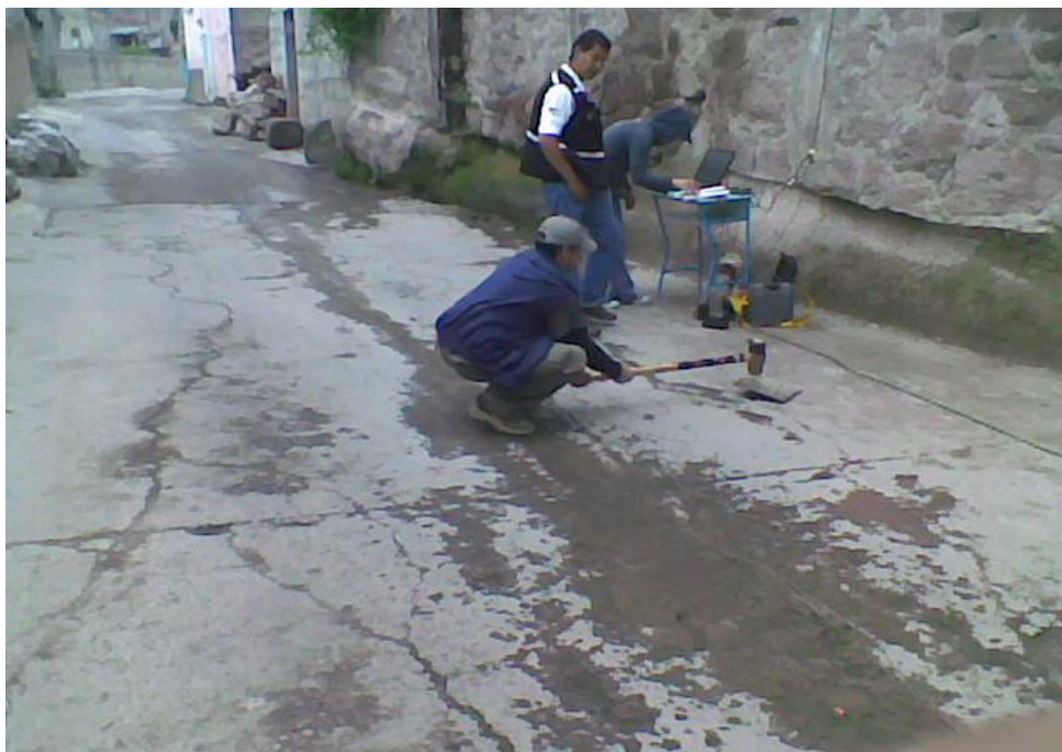
Figura 28. Punto de Tiro 1 (PT-1), correspondiente al Tendido de Refracción Sísmica, TRS-6, realizado en la avenida de Otoño.
