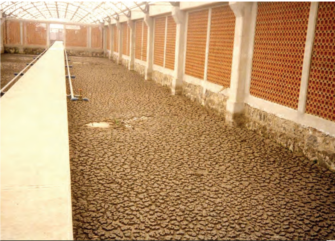
Fig. 13. Lodos residuales en patio de secado, planta de San Luis Tlaxialtemalco.
