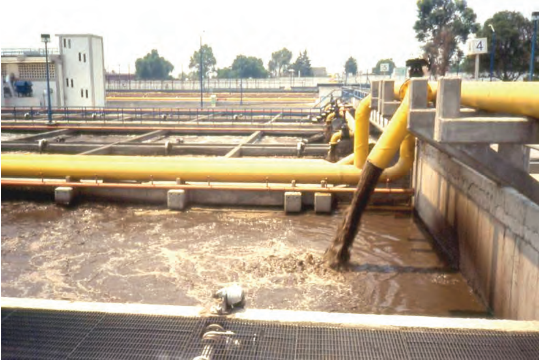
Fig. 9. Agua en etapa secundaria para la obtención de lodos residuales.
