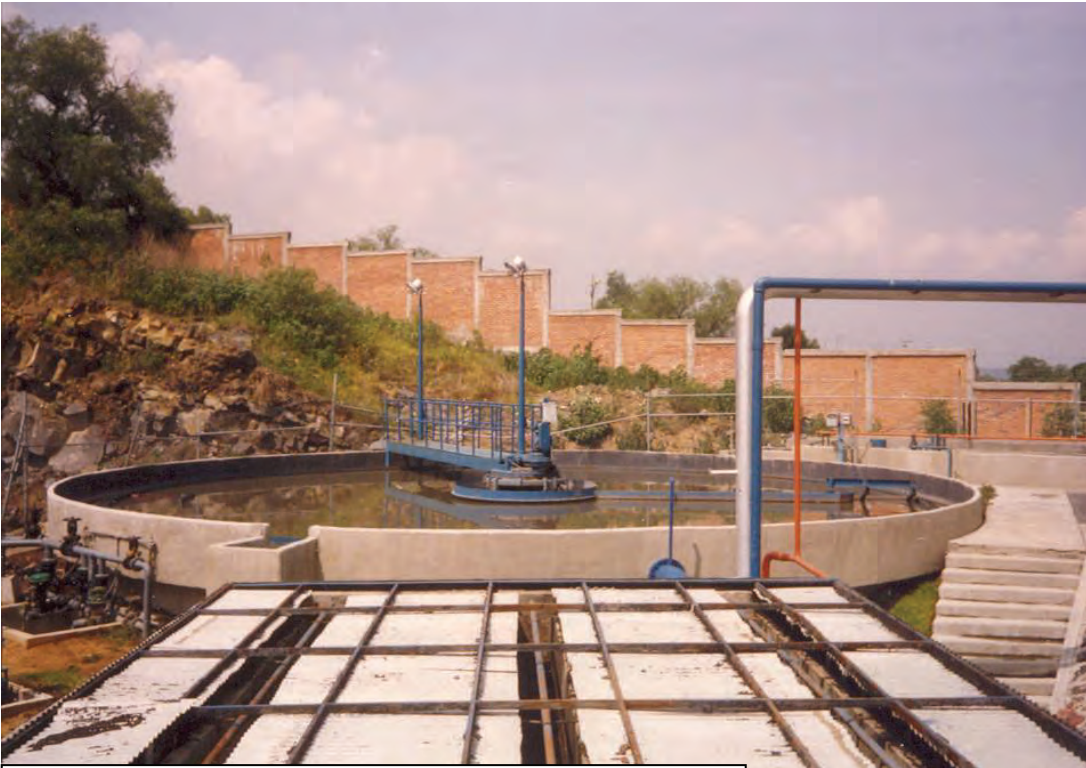
Fig. 7. Inicio del tratamiento primario en la Planta “Cerro de la Estrella”.
