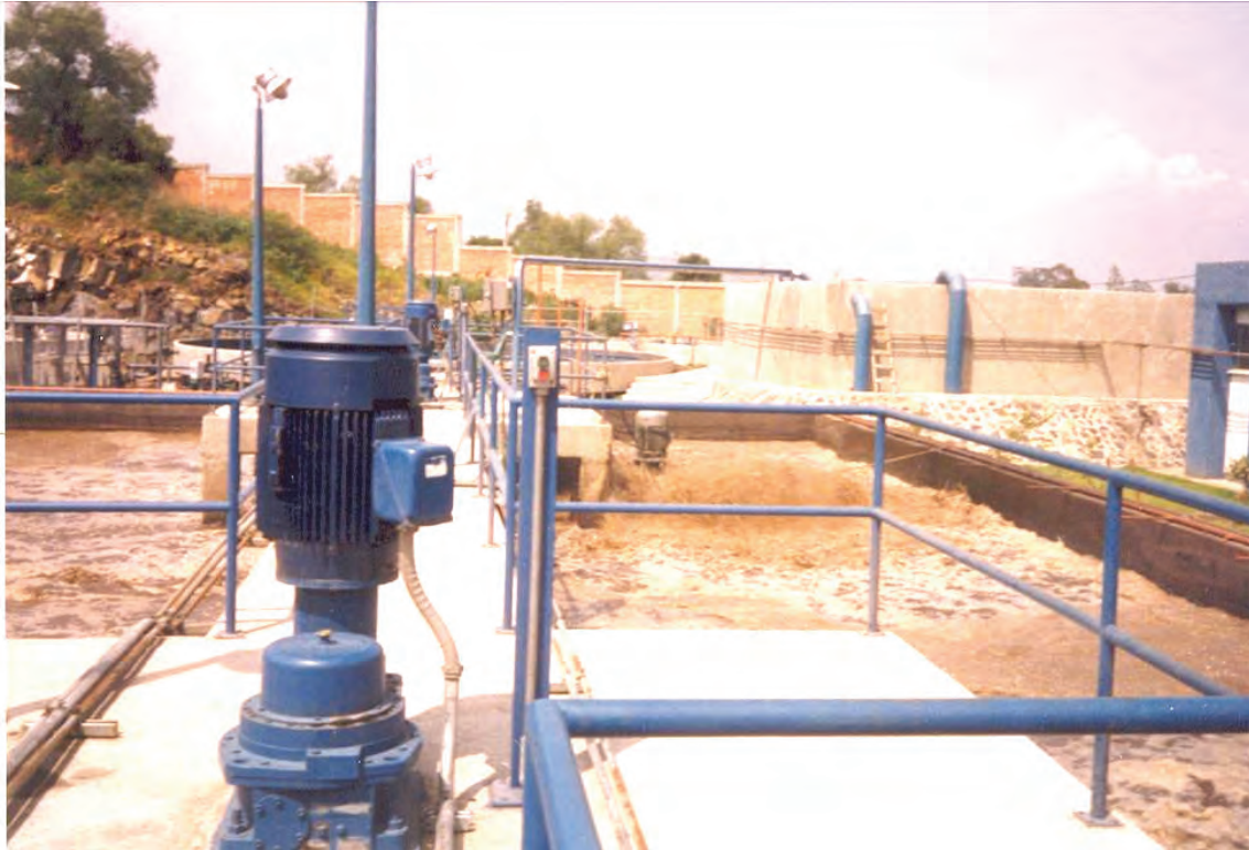
Fig. 8. Etapa de aireación del agua para proceder a la sedimentación de lodos residuales.
