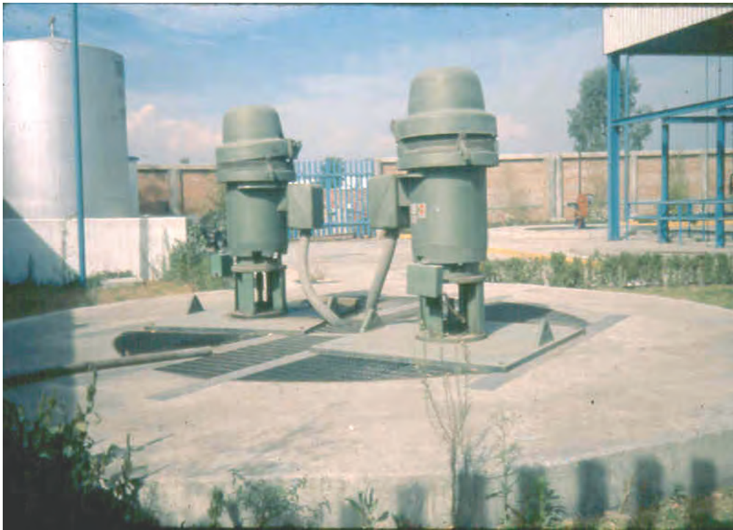
Fig. 5. Planta de bombeo “El Hueso”.
