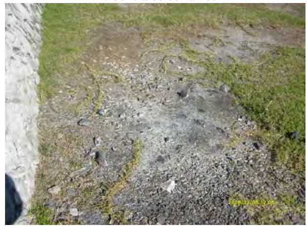
Fotografía 16. Manchas blanquizas (derrames) en suelo del área de tanques.
