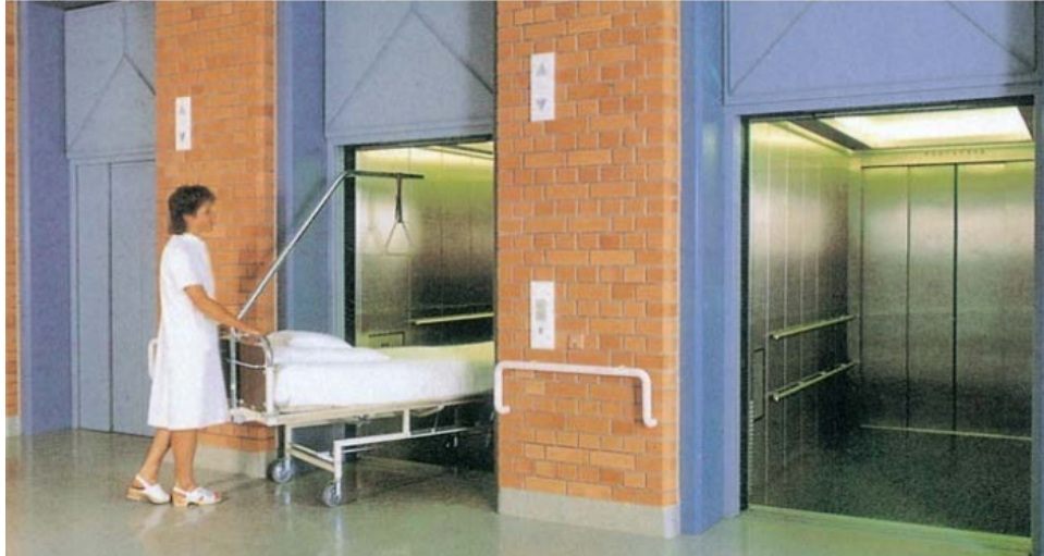
Figura 79. Elevadores en hospitales y clínicas.
