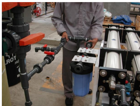
Foto 2. 4. Instalación hidráulica del filtro a presión a filtros cartucho.
