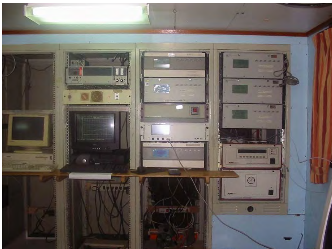
Figura 17. Analizadores de gases
