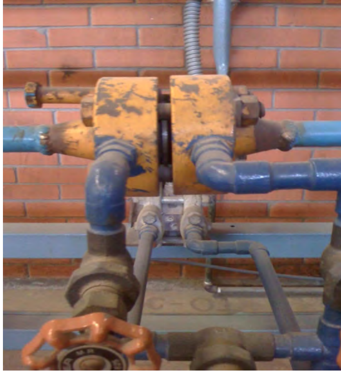
Figura 6.5. FT(al frente se observa la Placa de orificio, atrás se observa el transmisor)
