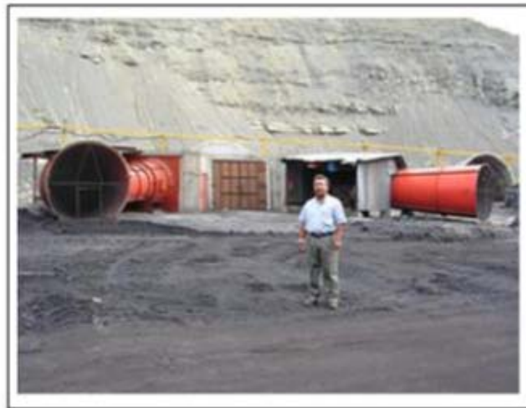
Fig. 3.2 Sistema de ventilación en una mina subterránea (Mina VII, MIMOSA)
