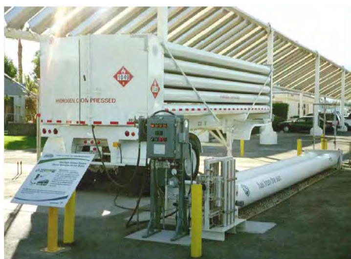
Figura 3.12 Transporte de H_2 por medio de tráileres o remolques
