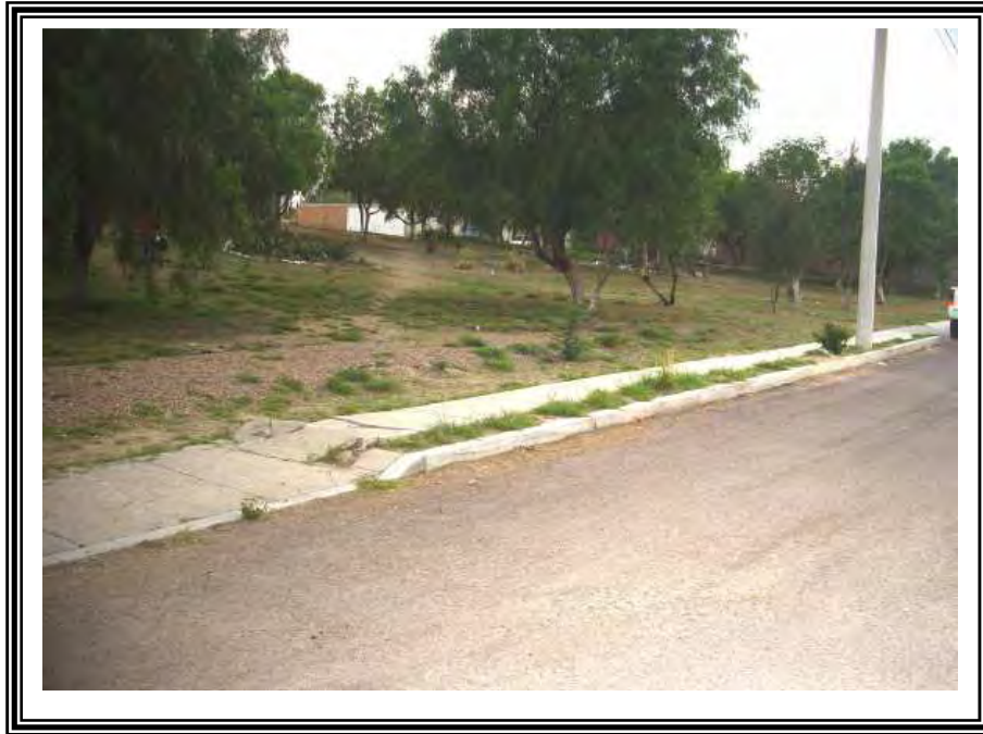
Figura 6.20. Remachadora de pavimento en la calle Olmo, con un largo de cuatro metros de afectación.
