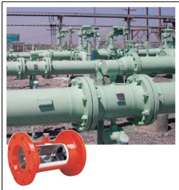
Fig. 3.55 Medidor de Turbina Smith Meter MT instalado en la terminal de un oleoducto.
