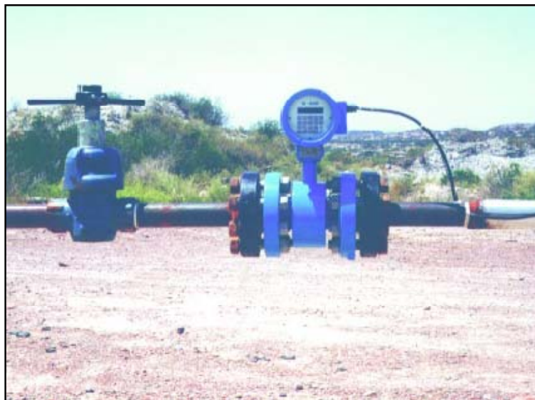
Fig. 3.74 Medidor instalado sobre una línea de hidrocarburos.
