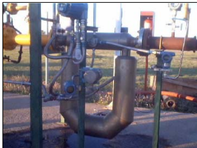
Fig. 5.4 Medidor Coriolis instalado en línea.
