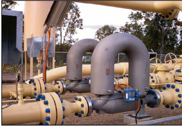
Fig. 4.33 Línea de gas.
