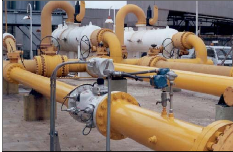
Fig. 3.67 Medidor instalado en planta de procesamiento.
