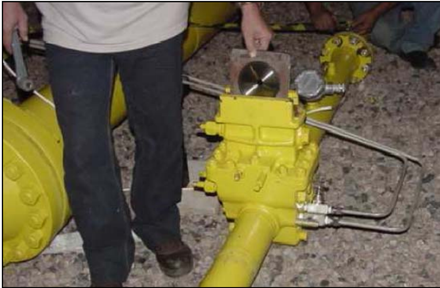
Fig. 3.27 Remoción de la placa de orificio en fitting.
