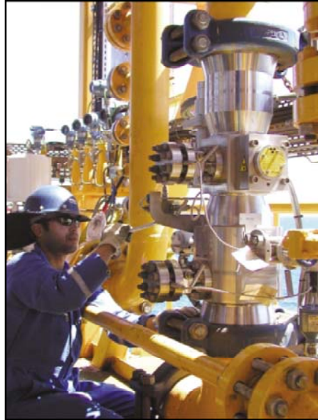
Fig. 2.7 Medidor Vx instalado en la plataforma Yombo.
