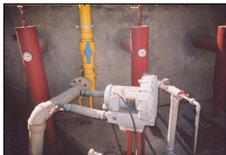
Figura 6.7 Sistema de bombeo (Bioverde, 2009)
