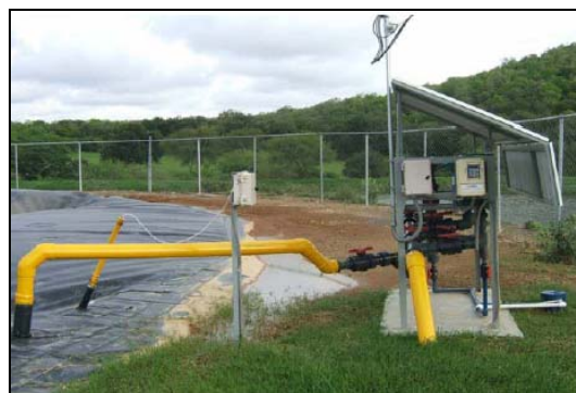
Figura 6.5 Medidor de biogás (Bioverde, 2009)
