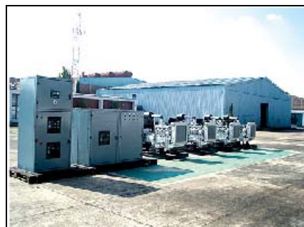
Figura 4.3 Sincronía entre varios motogeneradores (Mopesa, 2009)
