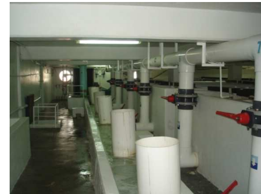
CUARTO DE MAQUINAS
