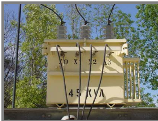
Figura 2.97. Transformador de servicios propios de 45KVA, trifásico.
