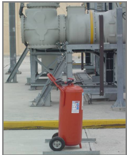
Figura 2.103 Extinguidor en el área de interruptor de potencia.
