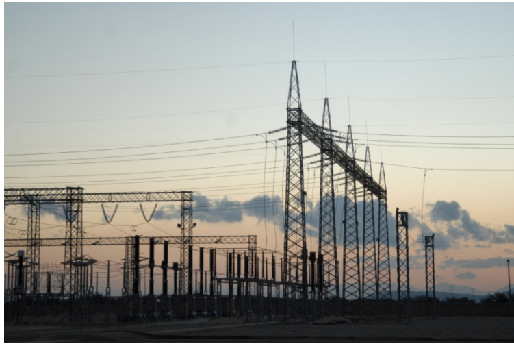
Figura 1.7. Subestación con líneas de 115KV.
