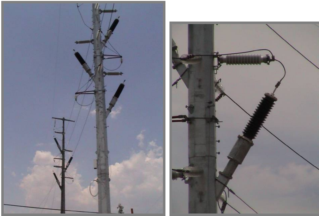
Figura 2.78. Apartarrayo oxido de zinc a la llegada de las líneas de la S.E.
