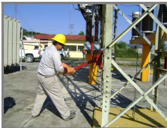
Figura 2.76. Cuchillas desconectoras de operación en grupo.
