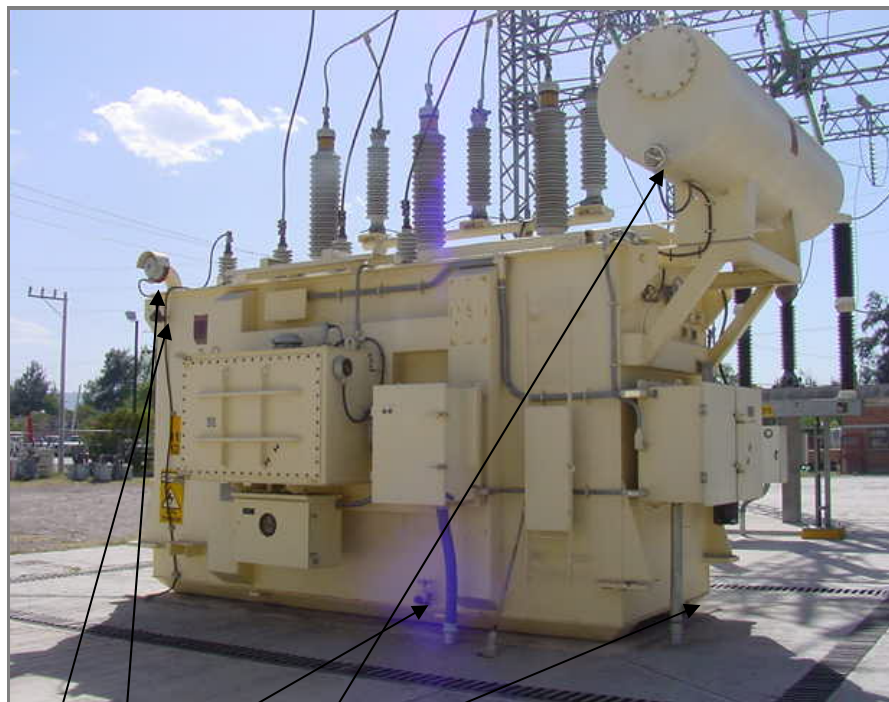
Figura 2.17. Transformador reductor de 115KV / 13.8KV.
