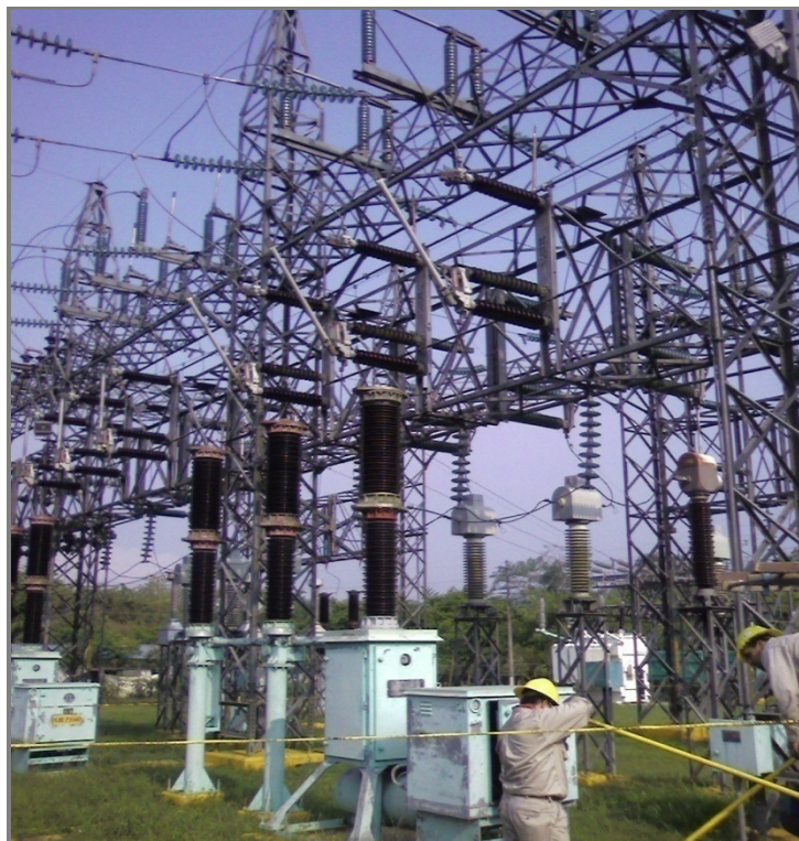
Figura 1.4. Imagen de subestación mixta; donde se observa el transformador reductor y cuchillas en la llegada de la subestación en 115kv (derecha) y salida de la línea hacia otra subestación (izquierda)
