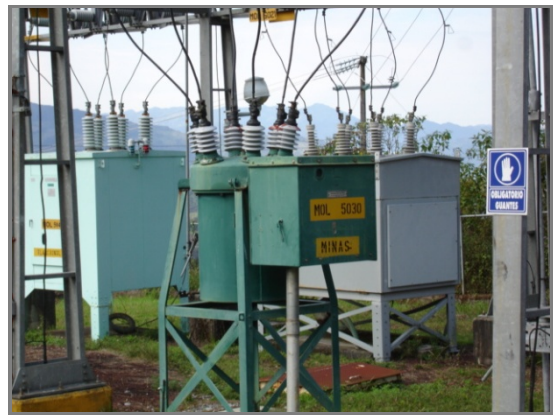
Figura 2.42. Interruptor gran volumen de aceite trifásico.
