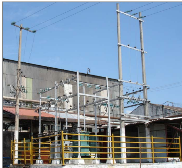
Figura 1.9. En esta subestación reductora donde se observa transformador de 500KVA-13.8kv 220/127Volts
