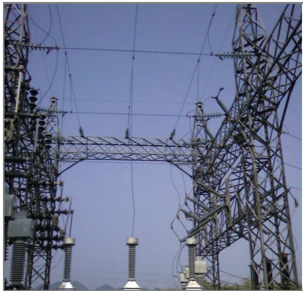
Figura 3.5. Bus principal, con el tipo de barra ACSR.
