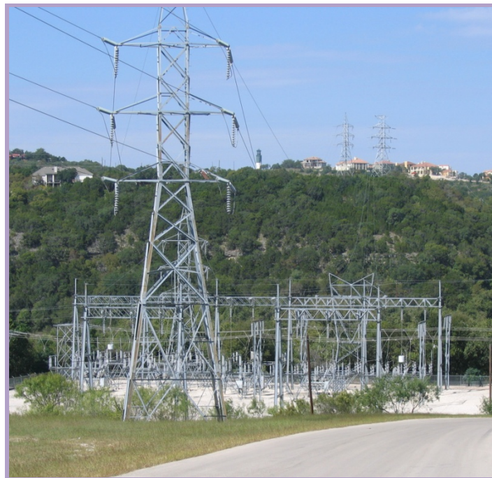
Figura 1.2. Imagen de subestación de maniobra o seccionadora de circuito; donde se observa la línea de 85kv y cuchillas desconectadoras motorizadas.
