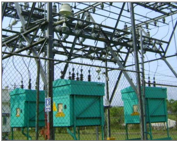
Figura 2.48. Interruptor al vacío con aislamiento en aire.
