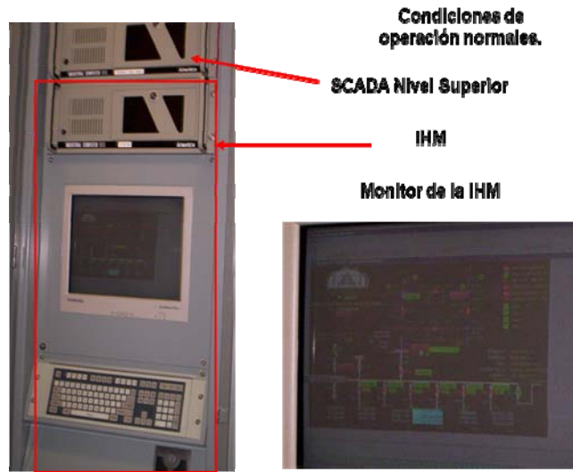
Figura 107. Equipo de comunicación de voz y datos ubicados en caseta de la subestación.
