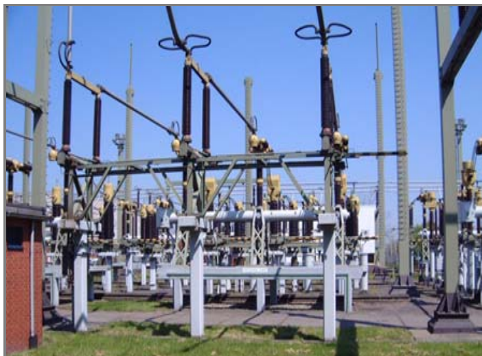
Figura 1.10. Subestación tipo Intemperie, Cuchillas de Operación en Grupo en 230kv.
