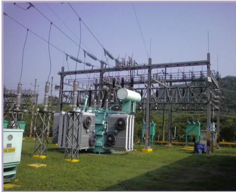
Figura 1.3. Imagen de subestación reductora, donde se observa el Transformador de Potencia 10MVA-115/13.8/7.967KV
