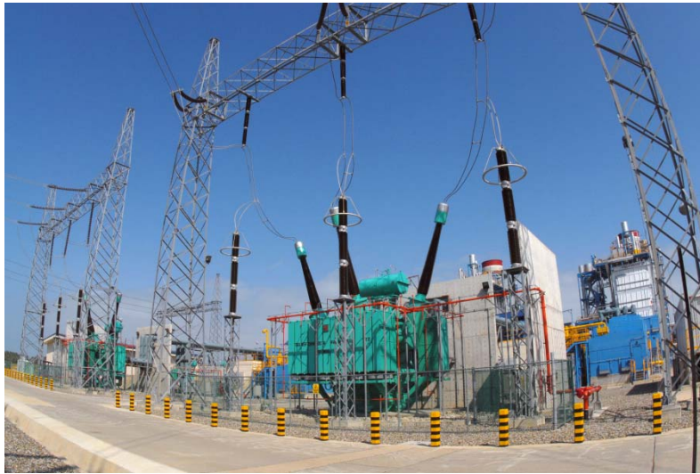
Figura 1.5. Imagen de subestación elevadora donde se observan dos transformadores elevadores trifásicos en 20KV/400KV 300MVAS.
