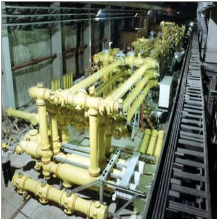
Figura 1.11. Subestación encapsulada a 230 kV, aislada en gas SF 6 , con encapsulamiento monofásico y en configuración de doble barra.
