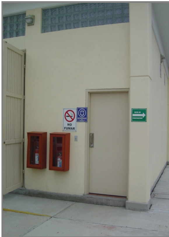
Figura 2.102 Extinguidor en el área de banco de baterías.
