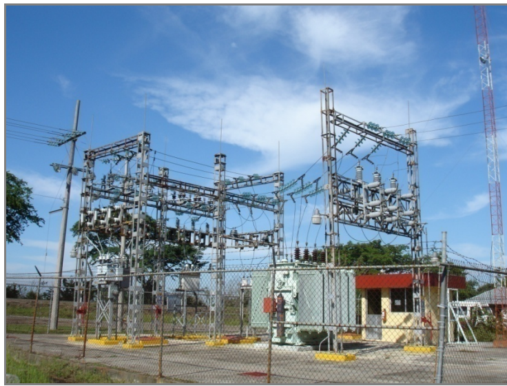
Figura 1.8. Subestación reductora de 5MVA-33/13.8kv
