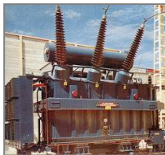
Figura 2.29. Transformador de potencia.
