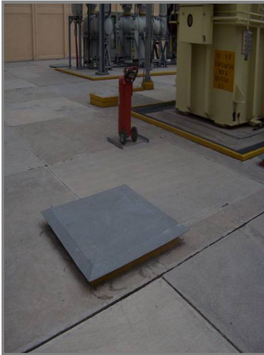
Figura 2.100 Extinguidor en el área de transformación y trincheras.
