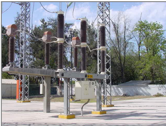
Figura 2.45. Interruptor en SF 6 en tanque en vivo.
