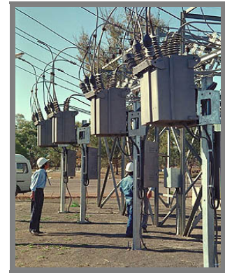
Figura 2.55. Restaurador electrónico, con cámara de vacío aislado en SF 6 .
