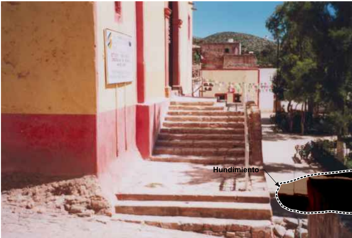
Fig. 13.1.4 Hundimiento frente al Templo
