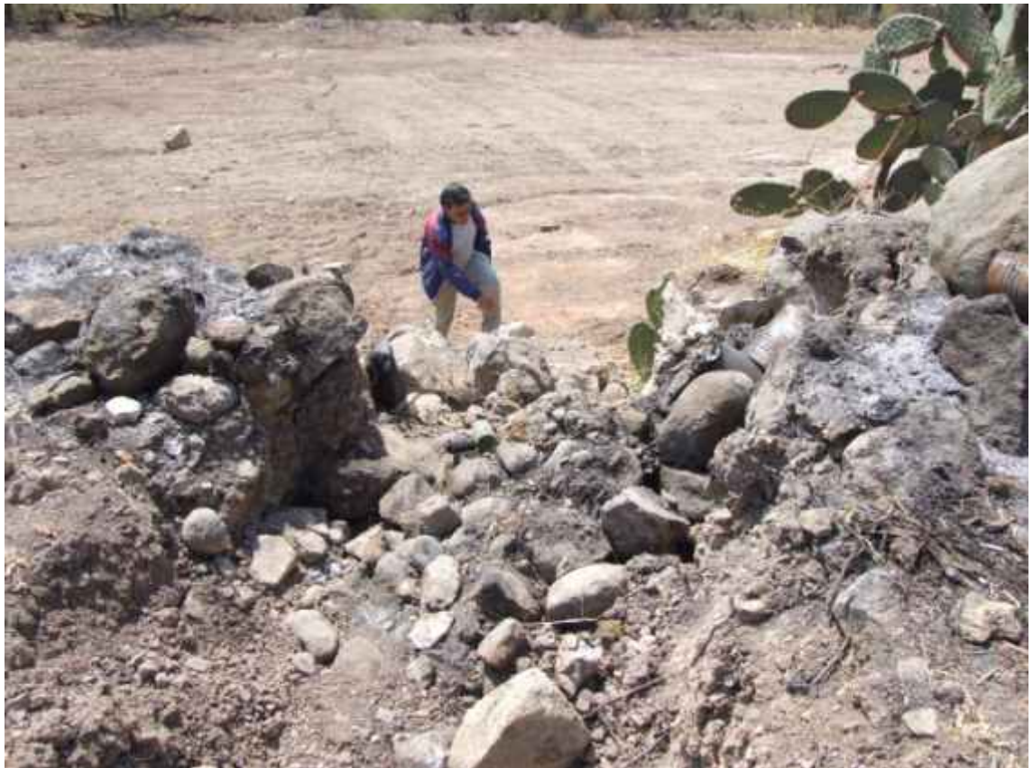
Fig. 9.2.12 Daños en el muro de contención en el paso de la grieta principal
