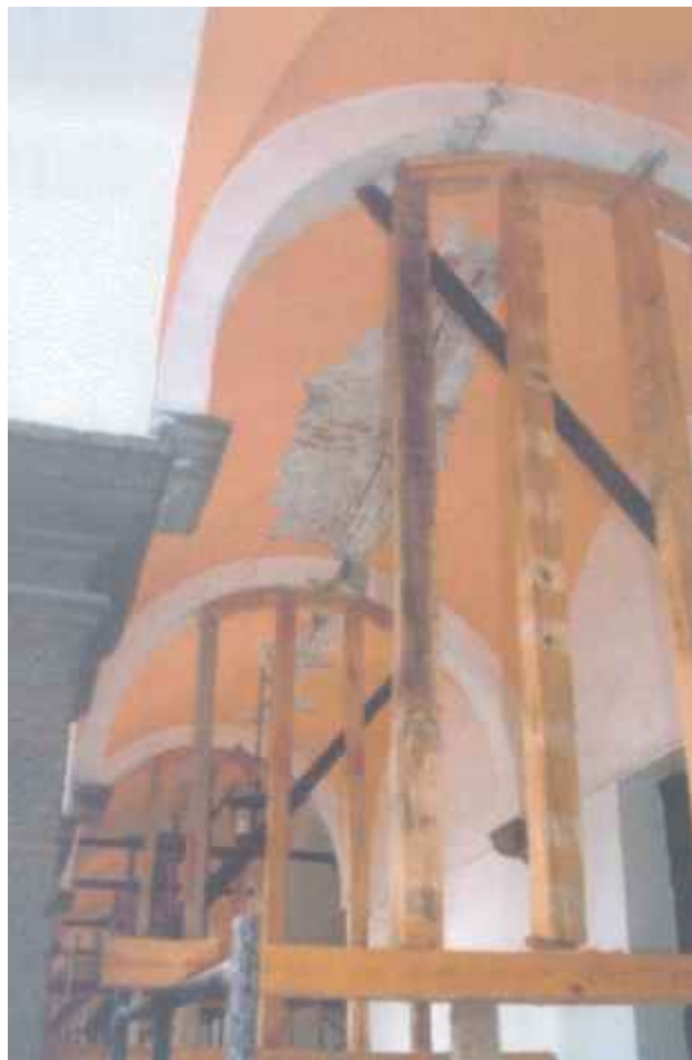
Fig. 11.2.4 Corredor SE del 3er patio fue apuntalado de emergencia
