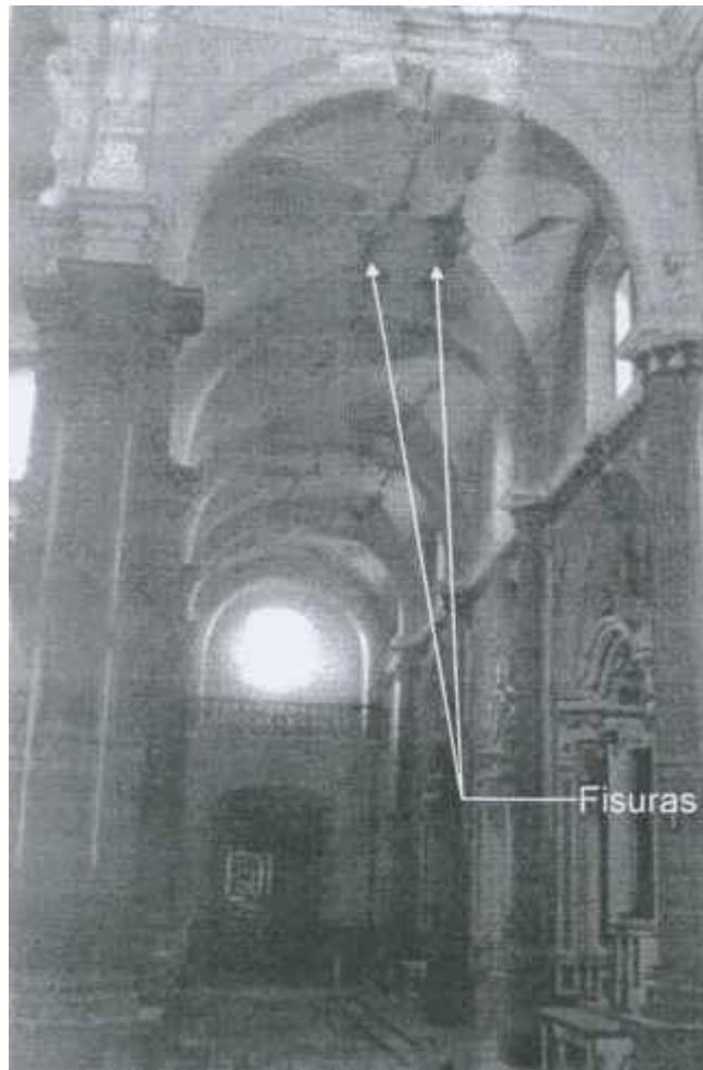
Fisuras en una de las naves laterales de La Compañía
