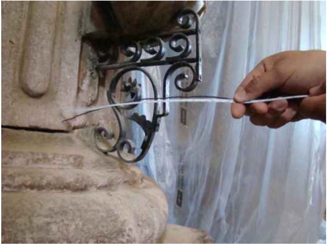
a) Fisura en una pilastra
