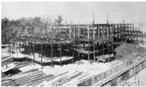
Fotografía tomada en diciembre de 1906, cuando empezó a causar alarma el hundimiento diferencial.
