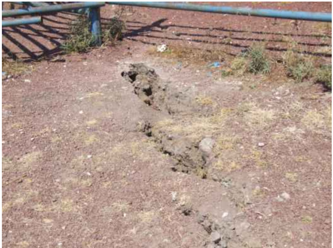
Fig. 9.2.9 Grieta en el terreno sur del templo
