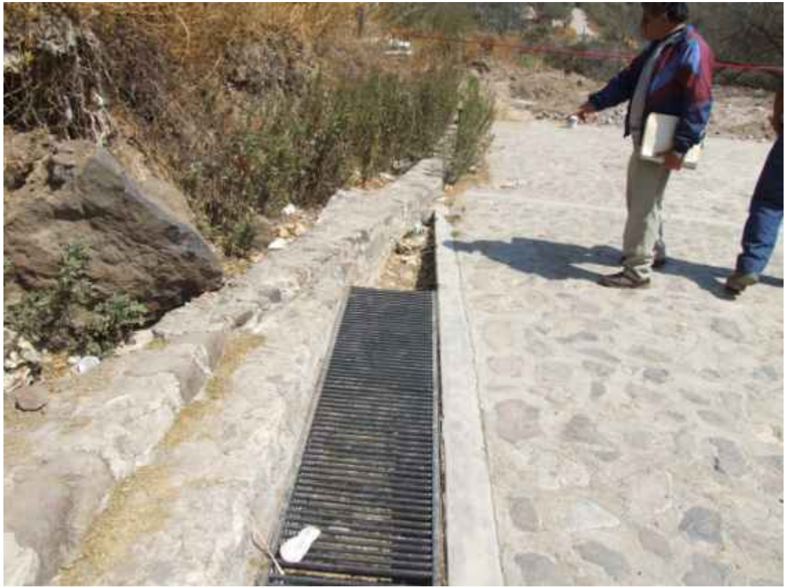
Fig. 9.2.16 Rejilla de drenaje inmediata al atrio sur
