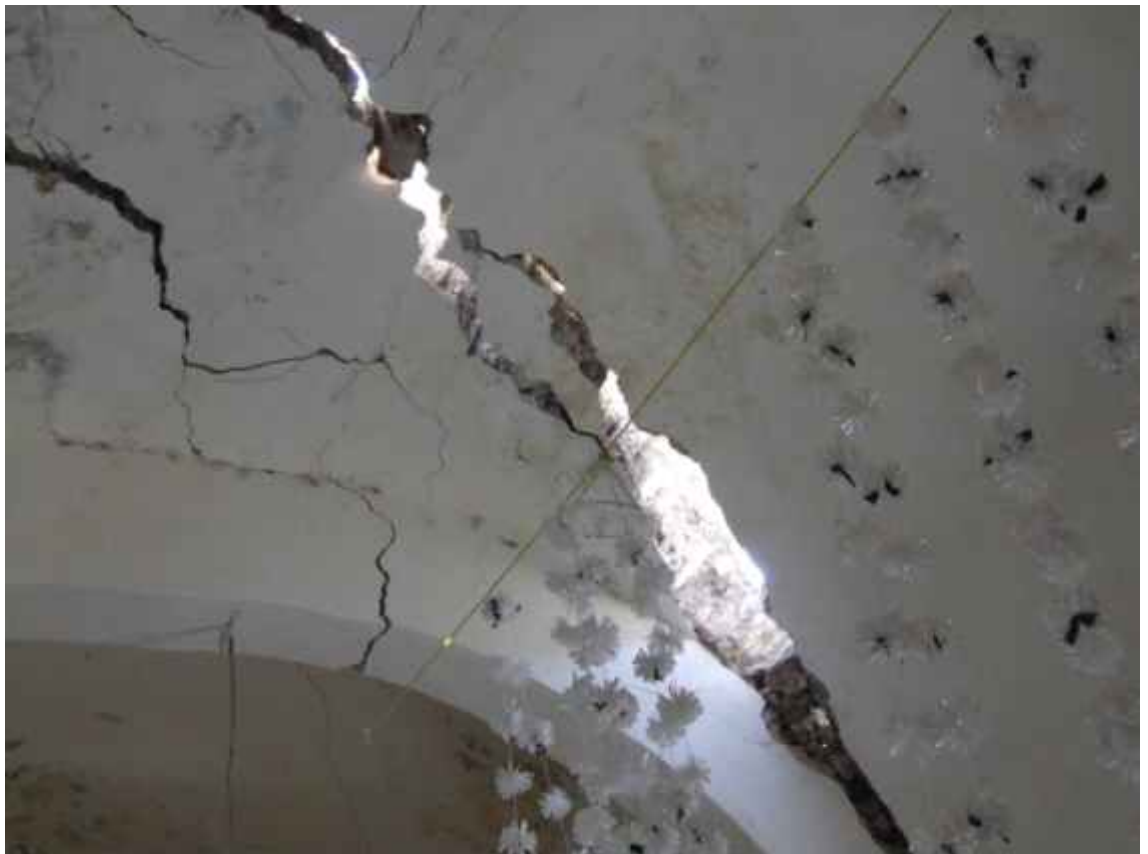
Fig. 9.2.6 Daños en la bóveda del templo
