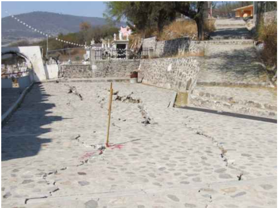
Fig. 9.2.4 Daños en el atrio norte
