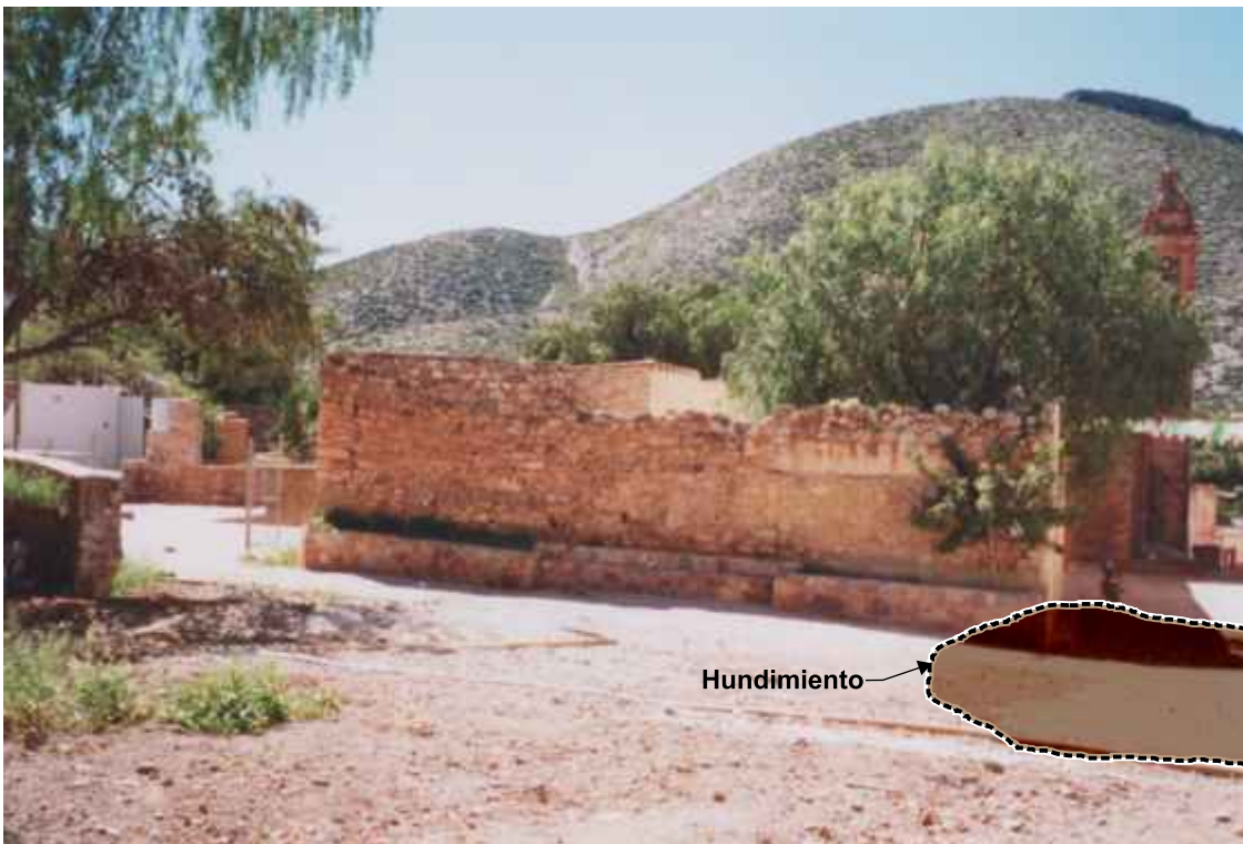
Fig. 13.1.5 Hundimiento al sureste del Templo
