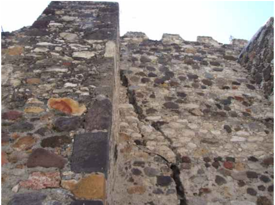
Fig. 9.2.5 Grietas en el muro norte del templo
