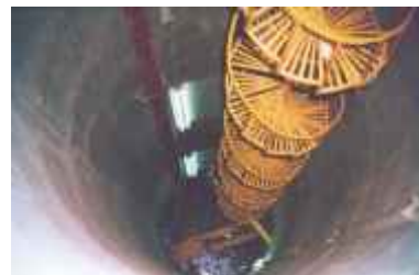
Se observa una lumbra de acceso a los suelos blandos.
