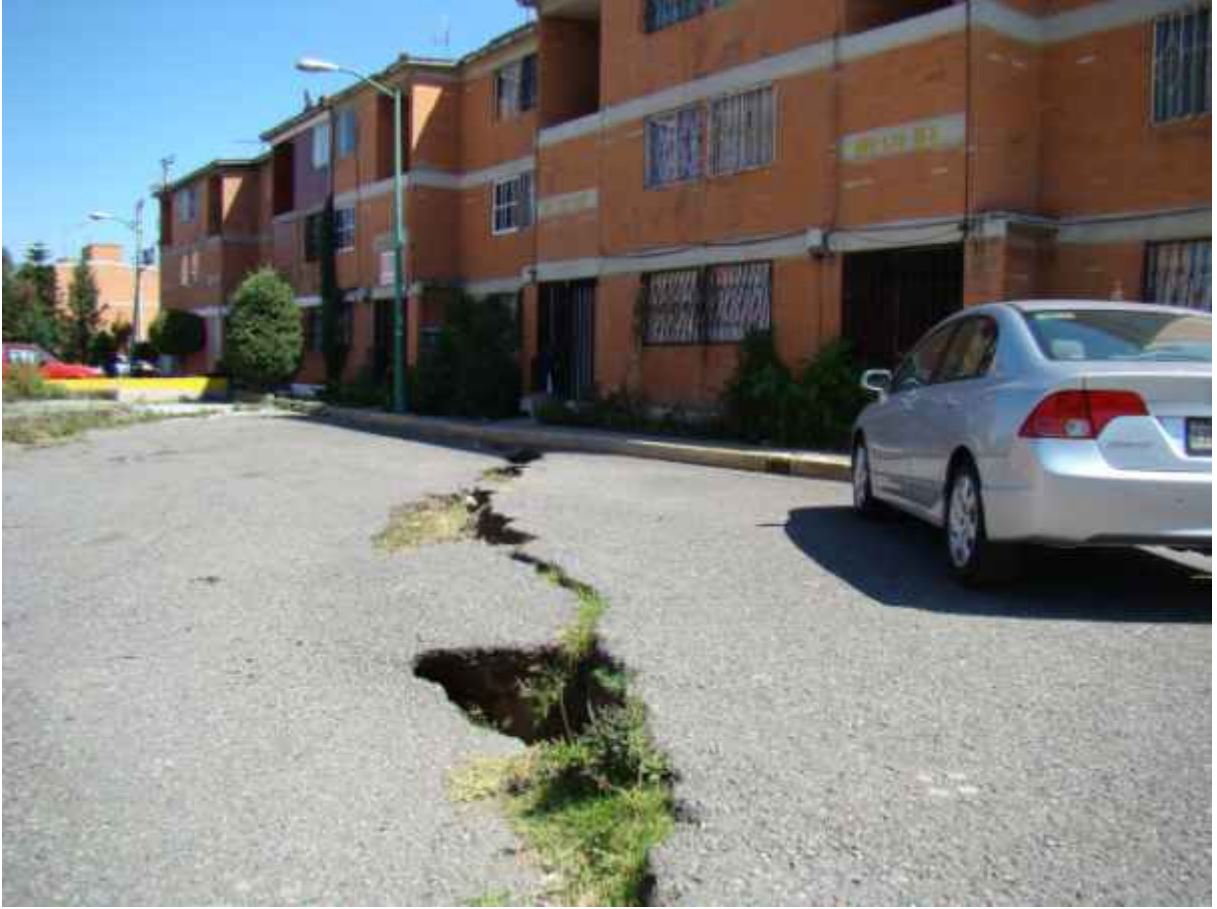
Fig. A.11 Grieta típica
