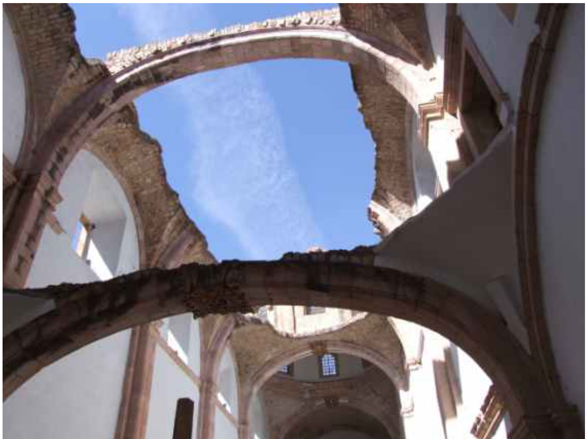
Fig. 10.2.2 Bóveda colapsada en 1924, Templo de San Francisco, Zacatecas
