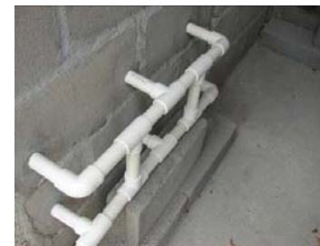
FOTO III. 5. SISTEMA DE INYECCIÓN ORIENTE. Vista interior del muro oriente del sistema de inyección de aire.
