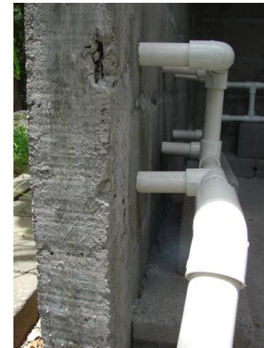
FOTO III. 6. SISTEMA DE INYECCIÓN. VISTA LATERAL DEL SISTEMA DE INYECCIÓN EN EL MURO ORIENTE
