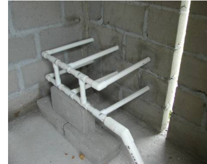
FOTO III.7. SISTEMA INYECTOR MURO PONIENTE. Puede observarse que las entradas individuales de aire insertadas en el muro, tienen una longitud mayor a la propuesta en proyecto.
