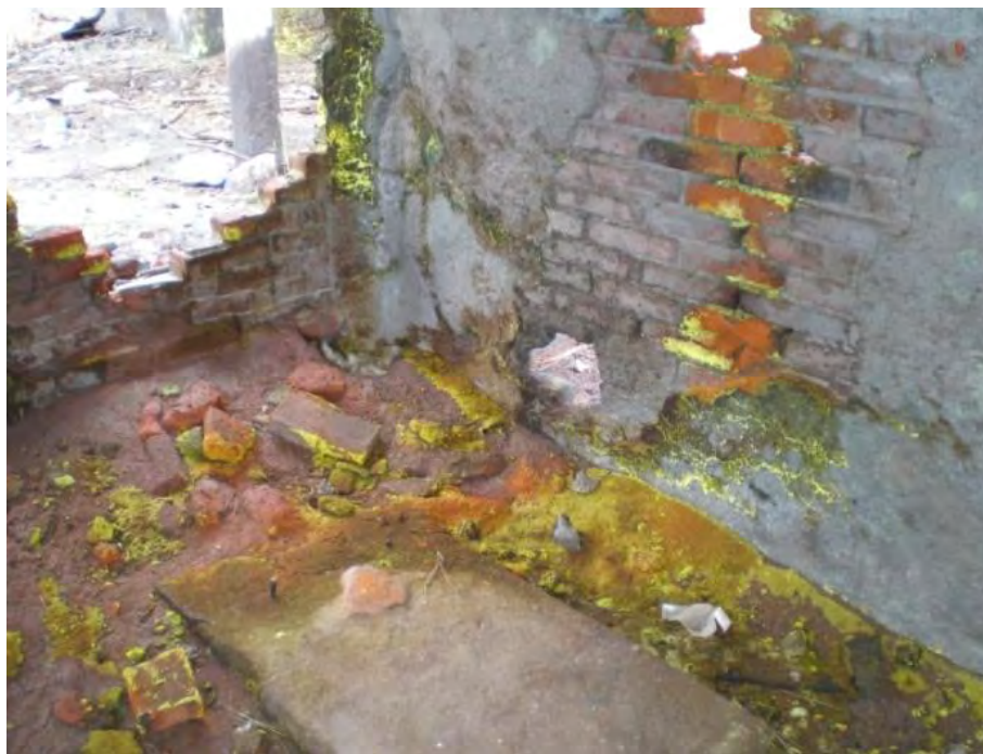
Figura 5.- Muros contiguos al confinamiento con residuos industriales con cromo. Nótese las partes amarillas, características de la condición oxidante del cromo
